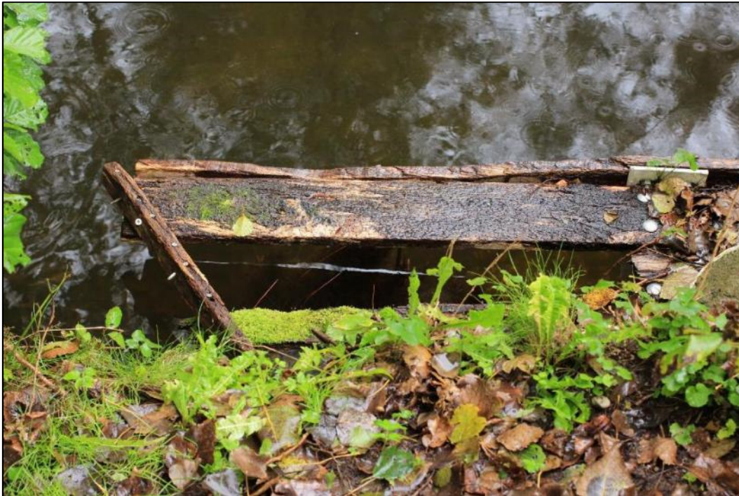
Abbildung 14: Defekte Berme Havelbrücke östlich von Granzin
